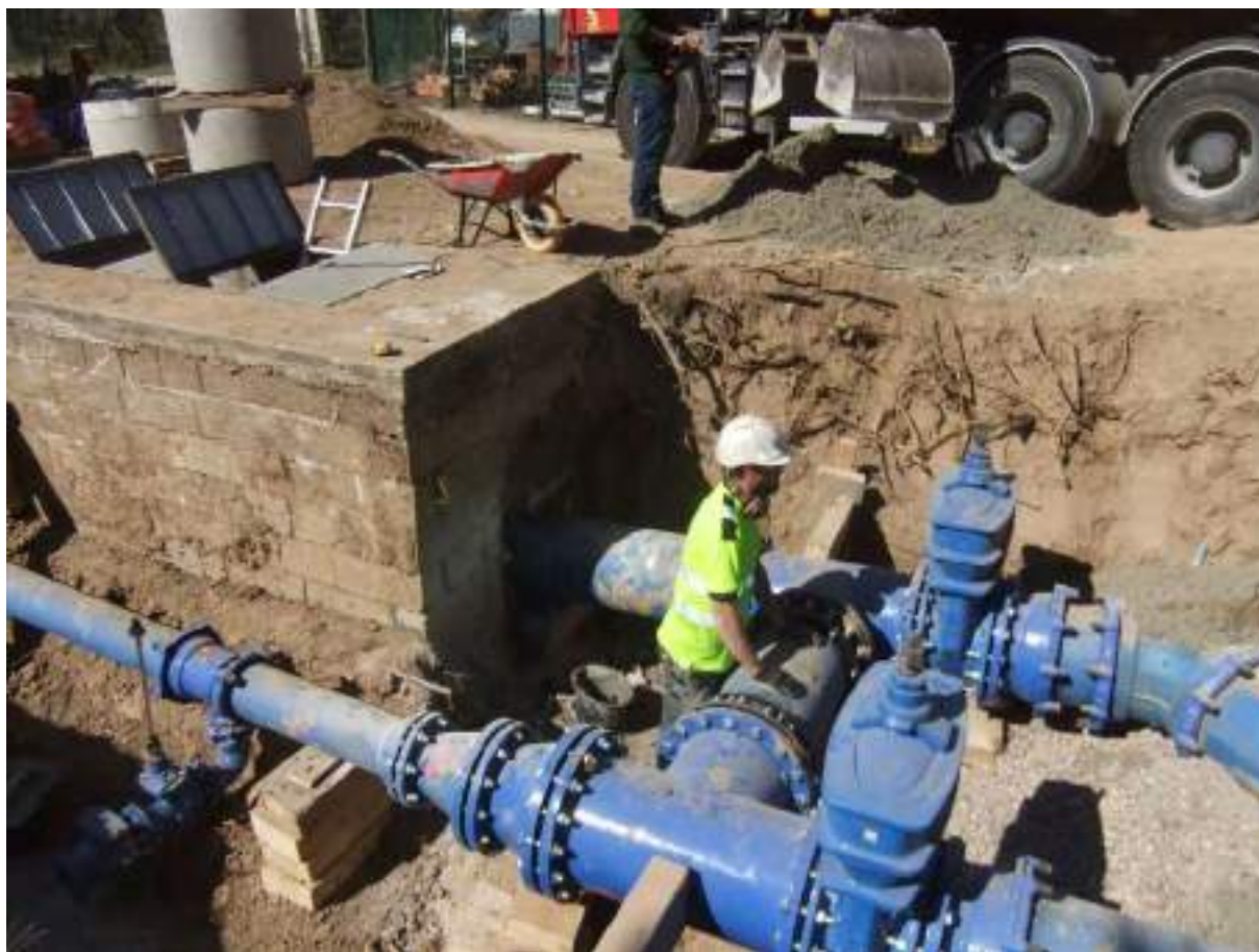
BASSIN EAUX BRUTE FUYEAU
